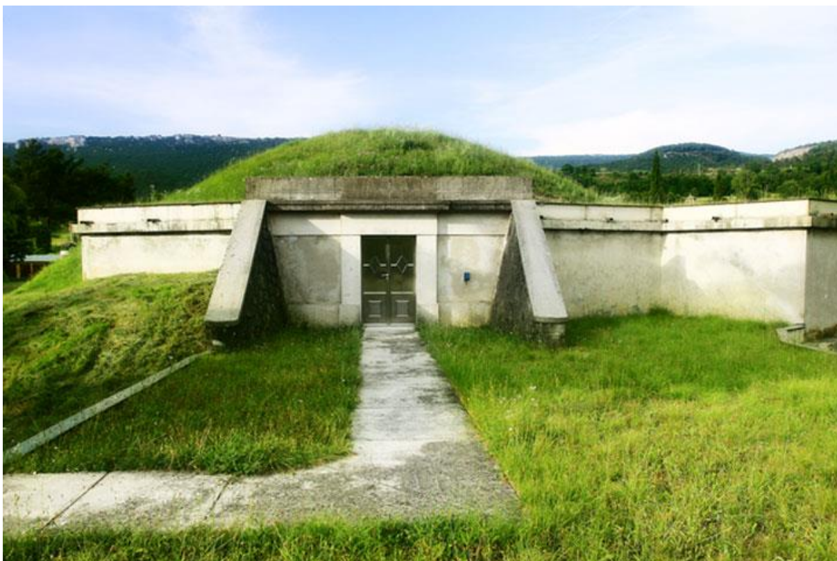
Kaptaža izvora Sveti Ivan u sklopu Istarskog vodovoda
